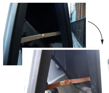
粗悪品 (徐々に錆びが発生し、やがて変形)
