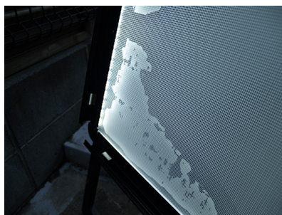
内部に溜まり、抜けない水
